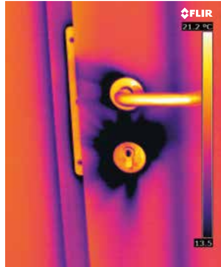
Luftundichtigkeit am Türbeschlag ist deutlich zu erkennen.
