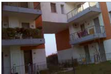
Tageslichtbild der Wärmeverluste am Gebäude
