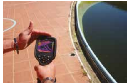
Die FLIR Wärmebildkamera konnte die undichten Stellen eindeutig lokalisieren.
