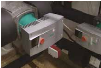
Wärme- und Tageslichtbild einer elektrischen Wasserpumpe.
