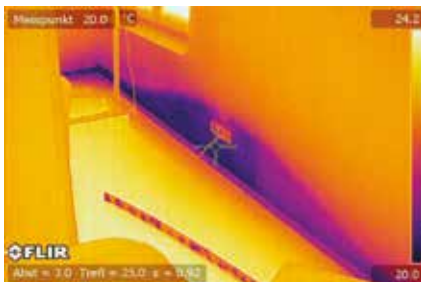
An diesem Fall von Wasserschaden lässt sich leicht der Vorteil der Bild-im-Bild-Funktion verdeutlichen, denn der Kunde kann ziemlich einfach erkennen, welchen Bereich die Wärmebildkamera gerade untersucht, was mit einem Wärmebild allein viel schwieriger wäre.
