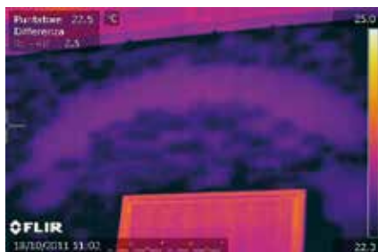
Dieses Wärmebild zeigt, dass diese Wand zur besseren Gewichtsverteilung unter der Oberfläche Bögen enthält.
